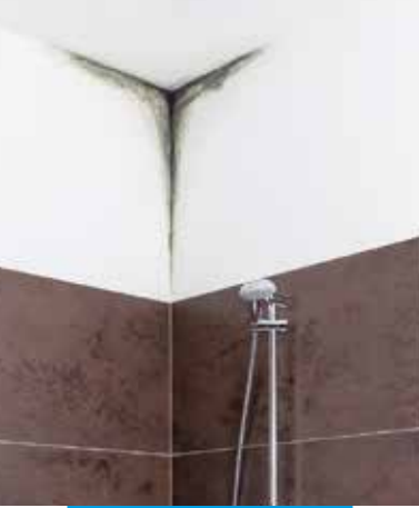
Povrchy evidentně napadené plísní
