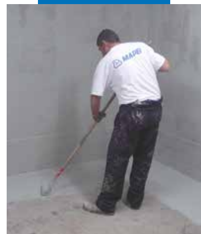
Mapelastic Foundation aplicado a rodillo, en una intervención de impermeabilización a contrapresión
