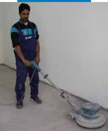
Lijado previo a la aplicación de Ultraplan Eco - Asilo Mirabello de Cantù - Italia
