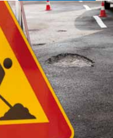
Bache en carretera listo para ser reparado
