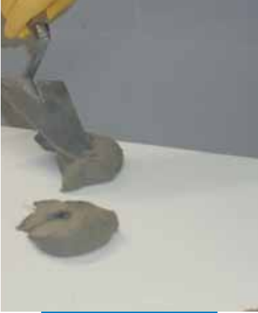
Εφαρμογή του Mapetherm AR1 στην πλάτη του μονωτικού φύλλου σημειακά με μυστρί
