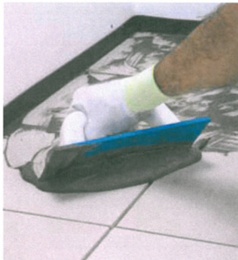
Fug rommets overflate
