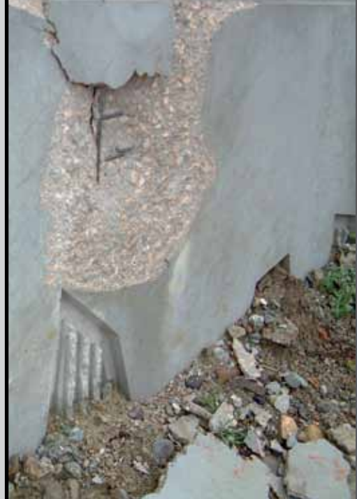
foto 15 Degradação devido ao gelo
