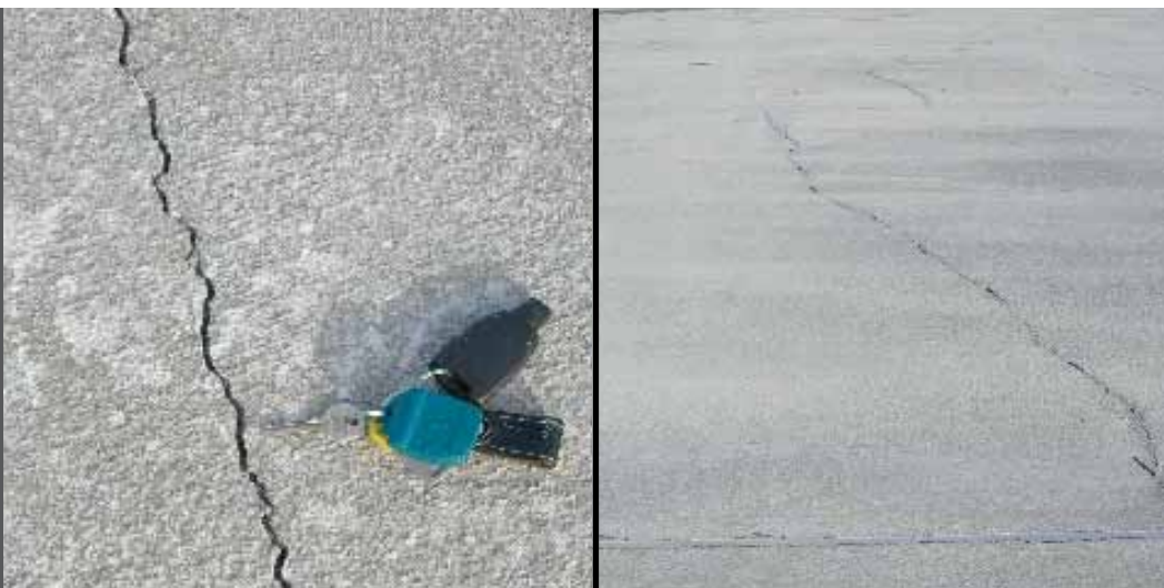
foto 16 Fissuração do betão
