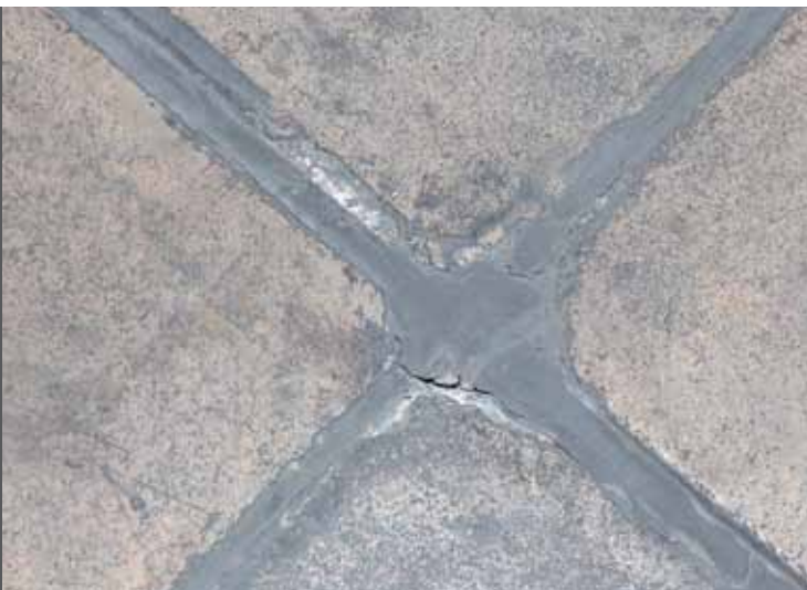
foto 19 Exemplo de degradação das juntas
