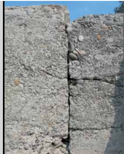
foto 18 Exemplo de erosão
