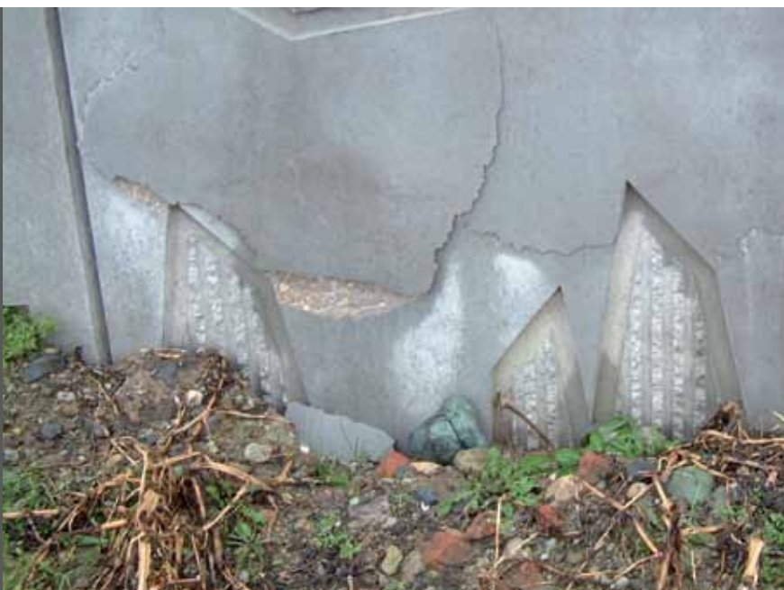
foto 14 Degradação devido ao gelo
