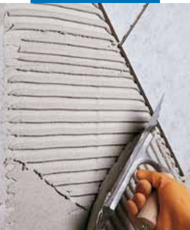
Assentamento em parede de revestimento em monocozedura sobre blocos de betão celular expandido
