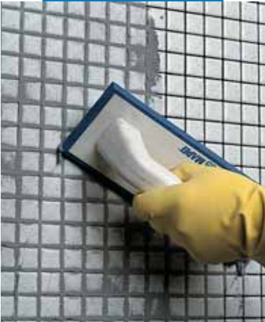
Betumação de juntas de revestimento em pastilha de vidro (numa casa de banho) com espátula
