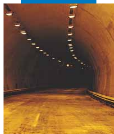
Aplicação por projecção de Idrosilex Pronto branco num túnel de uma auto-estrada
