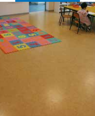
Linoleum instalat pe un suport nivelat cu sapa autonivelantă Ultraplan Eco - grădinița Mirabello - Cantù (Como) - Italia
