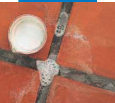
Curățarea petelor de eflorescențe
