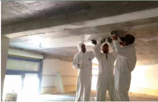
1 | Presidio sismico mediante applicazione di MapeWrap EQ System su tramezzature - Scuola dell'infanzia - San Vincenzo (LI)
